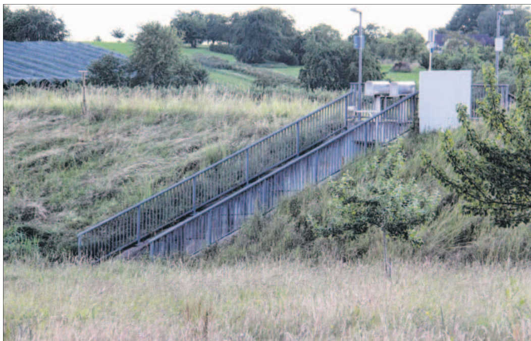
Mit dem Rückhaltebecken Brestenberg setzte sich der Ortschaftsratsrat Nußbach auseinander. Ziel muss nach Ansicht des Gremiums sein, die Ablaufmenge manuell reduzieren zu können. Foto: Meier
